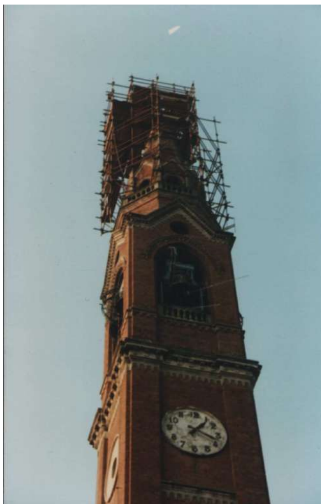
Fotografia della torre in occasione dei lavori di smontaggio impianto campanario - 1994 [ fonte: privato ]
